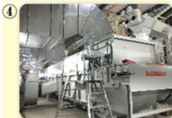
ベルトドライヤー (Rudnick&Enners 社製) 能力：2トン/時間 破砕されたチップを水分約10%まで乾燥する機械 ※熱はCHPから発生した温水を使用
